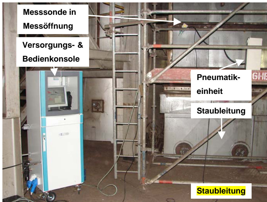
Abbildung 3: Messaufbau im Kraftwerk
