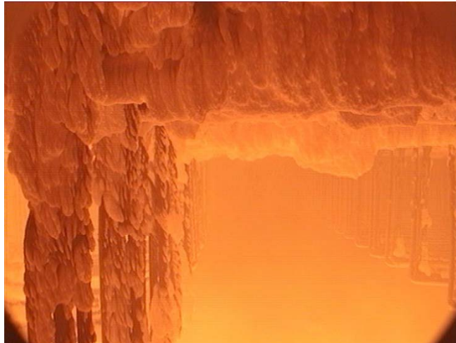
Abbildung 5: Verschmutzung im Bereich der Überhitzer (Braunkohle)
